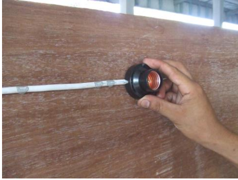
5) ฐานหลอดที่ติดตั้งเรียบร้อยแล้ว
